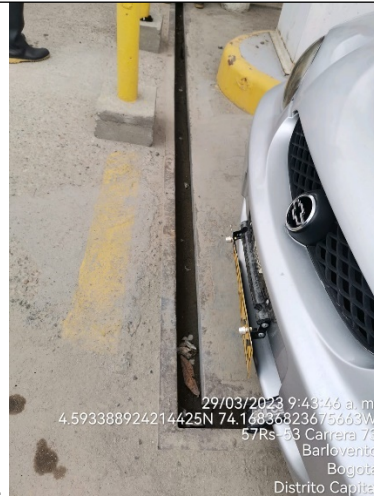
Foto 16. Canaleta del área de distribución y almacenamiento
