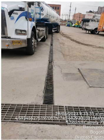
Foto 7 Rejillas perimetrales área de almacenamiento y distribución de combustible.
