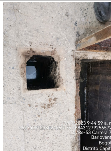
Foto 10 Caja de inspección interna de la EDS.
