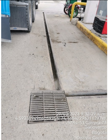
Foto 18. Canaleta de área de distribución y almacenamiento
